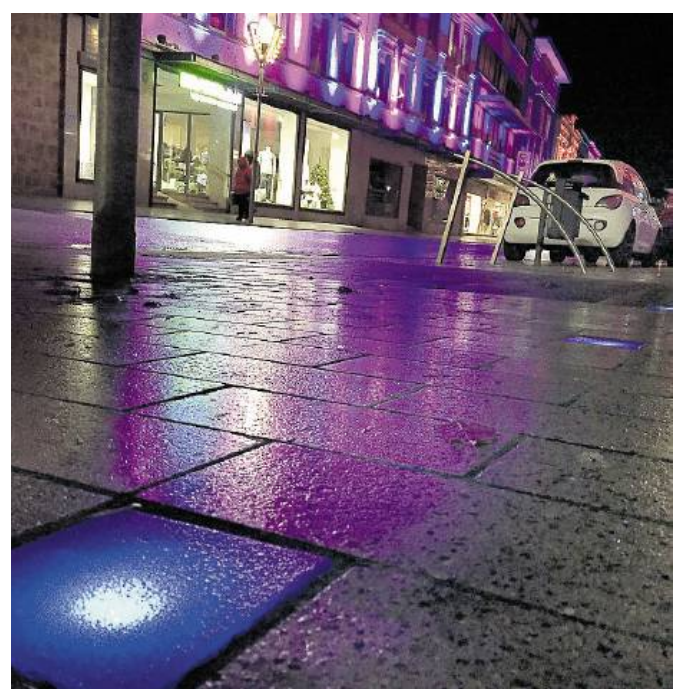
Hübsch, aber störanfällig ist das teure blaue Leuchtband im Bürgersteig der Bahnhofstraße. FOTO SCHMITZ
